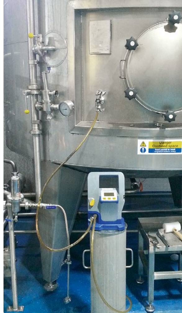
Измерение DO в резервуаре дозревания
